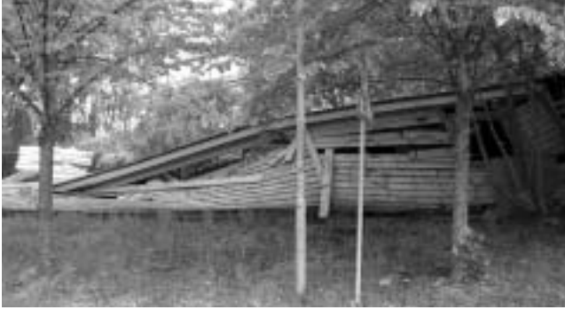
De gamle tyske garasjene var tæret av tiden.
